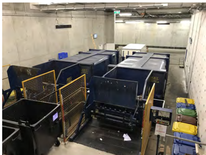
oben: Stationärpressen für Restmüll und Altpapier unten: Hauptmüllraum Foto: Campusmanagement
